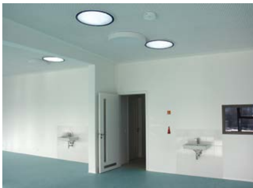
K přisvětlení jednotlivých místností bylo použito několik tubusových světlovodů, jež pomáhají rozptýlit světlo po celé ploše.
