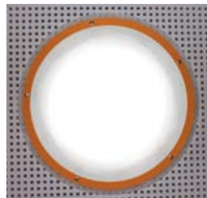
V interiéru byly použity ozdobné difuzéry různých barev s cílem vhodně je zakomponovat do architektonického vzhledu objektu.
